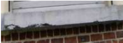
Dessous des rebords des fenêtres abîmés
